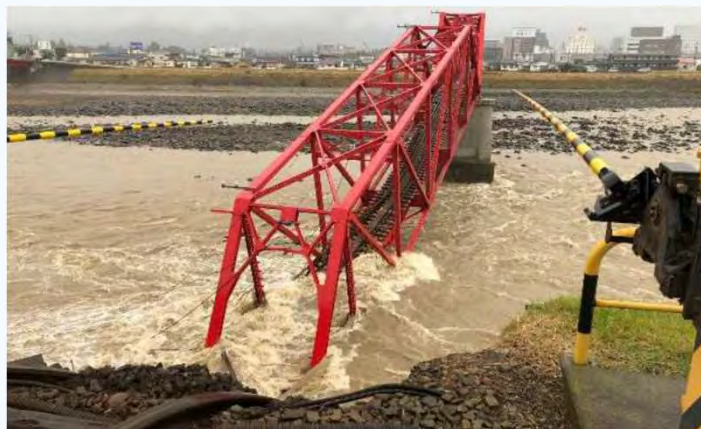
橋梁倒壊の状況（長野県上田市・千曲川）
