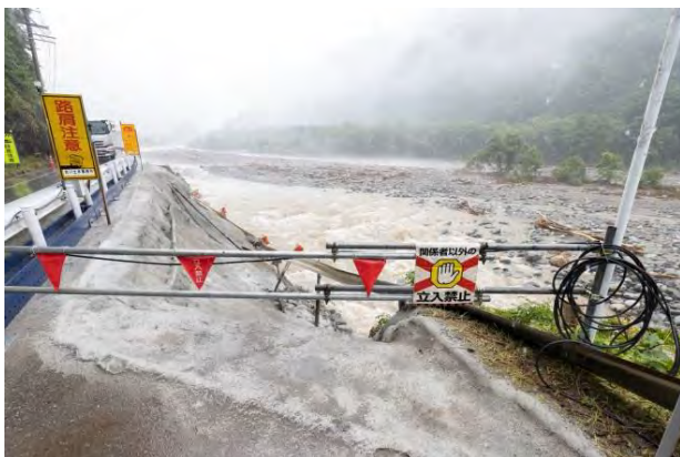
（国道路側決壊現場）
