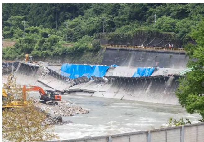
(J R高山本線 被災現場)
