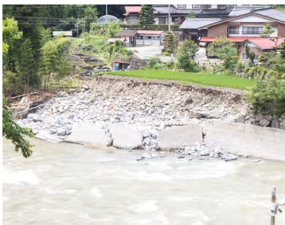
(飛騨川護岸決壊現場)
