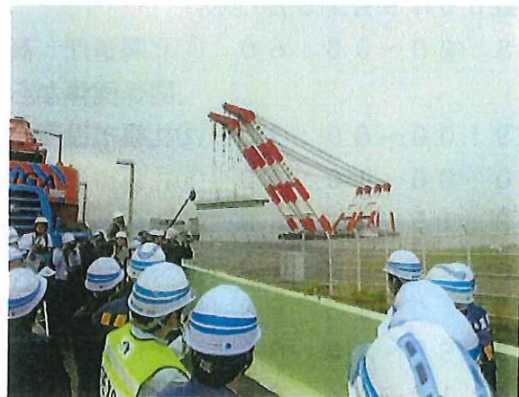
連絡橋から被害現場を臨む
