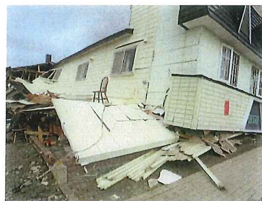
店舗だった一階部分がつぶれた建物
