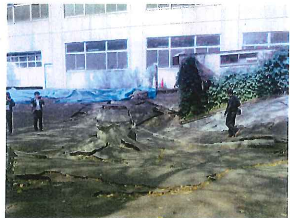
飛び出したマンホール
