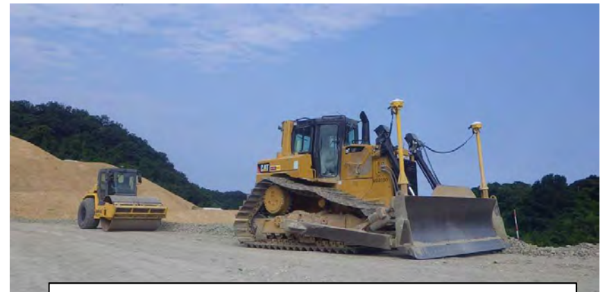
地場の測量機器メーカー等の連携により 後付け機器でICT施工を実施
